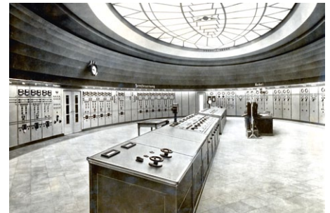
© BSW Gruppe Bahnstromanlagen S-Bahn, Bildarchiv
